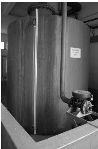
Figura 20.8 Contentor e respetiva bacia de retenção (em edifício)
