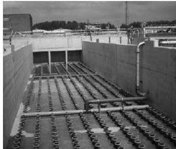
Figura 13.7 Difusores montados em tubagem distribuidora de ar
