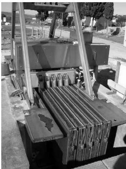
Figura 19.6 Instalação de desinfecção por UV
