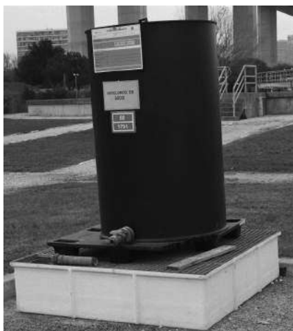
Figura 20.11 Contentor portátil e respetiva bacia de retenção
