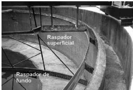
Figura 11.17 Raspadores superficial e de fundo do decantador
