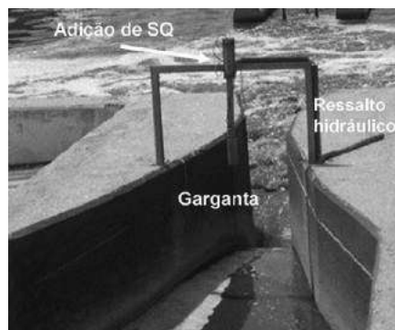
Figura 8.3 Misturador de ressalto hidráulico
