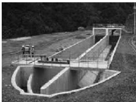
Figura 10.3 Desarenador de escoamento horizontal
