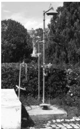
Figura 20.3 Chuveiro e lavador de olhos
